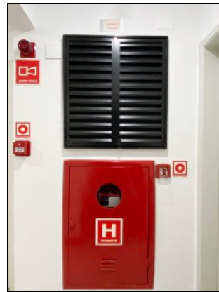
Alarme de incêndio
