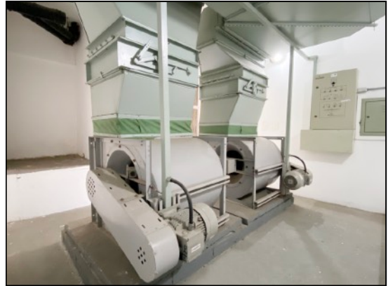
Pressurização-escada de incêndio
