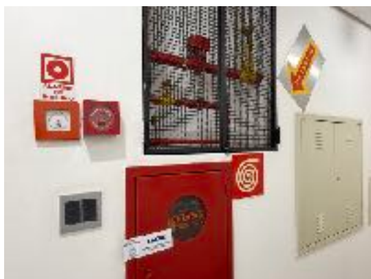
Hidrante/ extintor / alarme
